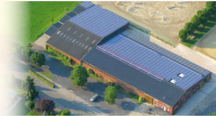
Photovoltaikanlage Reithalle Ascheberg 162 kWp PV-Anlage
